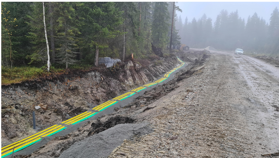
FIGUR 21. KABELGRAV MED KRAFTLEDNING OCH FIBERKOMMUNIKATIONSNET INTILL VÄG. (FOTO: ARCTAN)
