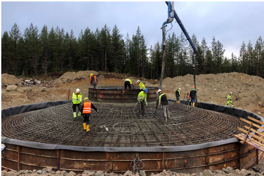
FIGUR 4-4: BYGGNATION AV GRAVITATIONSFUNDAMENT VID VINDKRAFTSPARK BLÅBERGLIDEN. HÄR SYNS DEL AV ARMERINGEN UNDER PÅGÅENDE BETONGGJUTNING.
